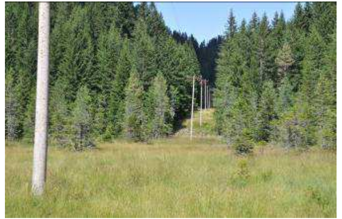
Una linea elettrica attraversa in sito da nord a sud
